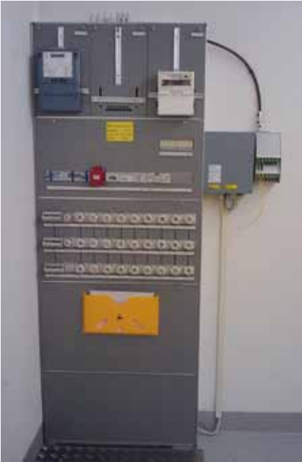
Beispiel einer CH-Trafostation, wo der zentrale Kommunikationsbaustein eingesetzt ist (kleine grau Box).
