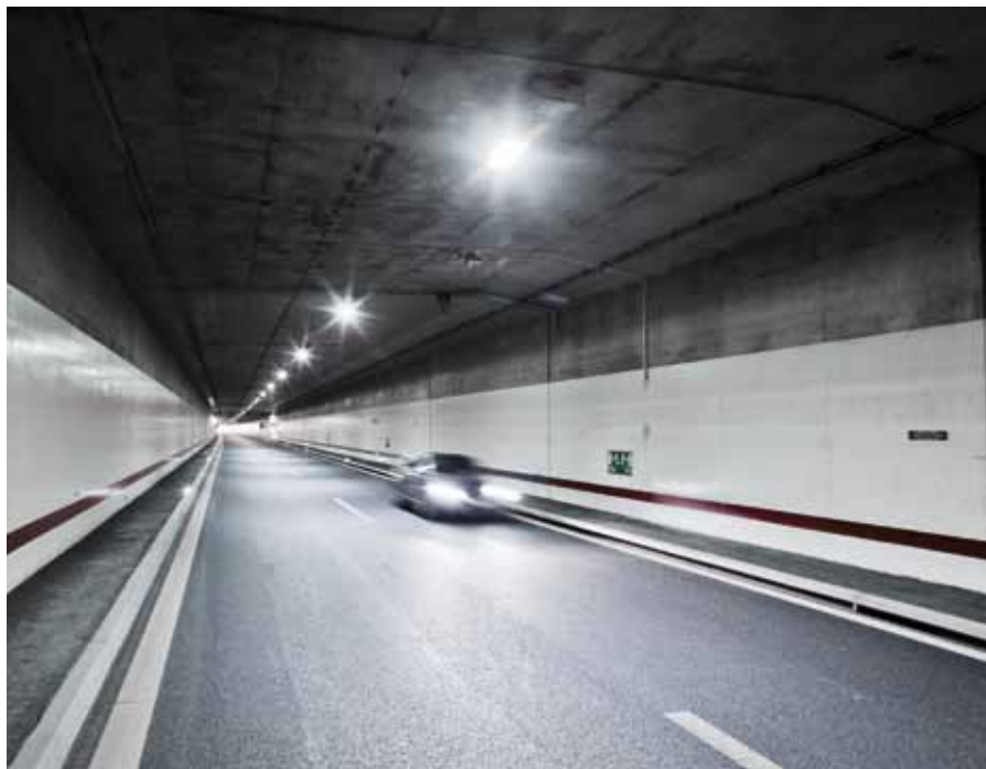
Beleuchtung (Tunnelabschnitt Witi) mit LED Technologie (80 Watt bei 100%). Bestückt mit elektronischem Vorschaltgerät für volle Dimmbarkeit und geringste Verlustleistung. Jede Lichteinheit ist via LON Powerline ansteuerbar
