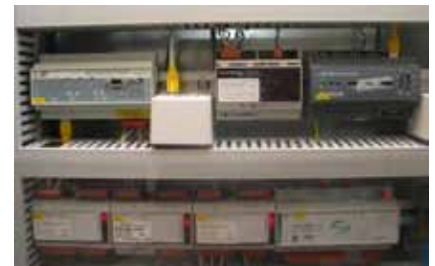
Eine echte Multivendoranlage: Komponenten von PentaControl, Infranet Partners (DALI-LON-Lamp Actuator), Loytec (LON-IP-Router) und Echelon (i-LON-Server) mit der Anschlussdose ans Netz. (Quelle: BUS-HOUSE).
